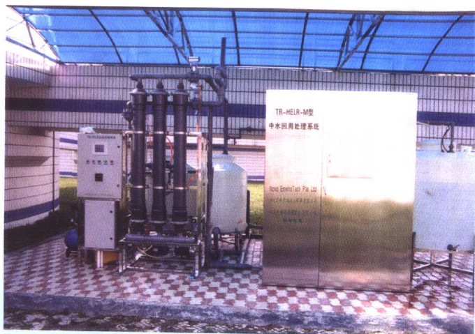
绵阳市塔子坝污水处理厂中水处理装置
