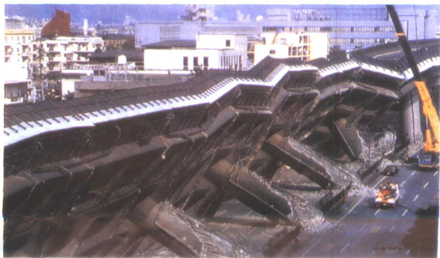
大阪地震中被倾覆的高速公路
