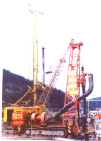
▲省地矿建设总包公司可施工 1.5~3米桩径的台湾S500自 行式反循环钻机
