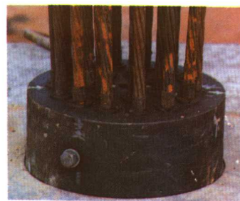
▲ 吊杆上的 XM 锚固端
