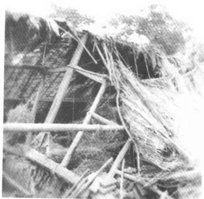
1. 溧阳东塘村民房毁坏，梁柱折断
