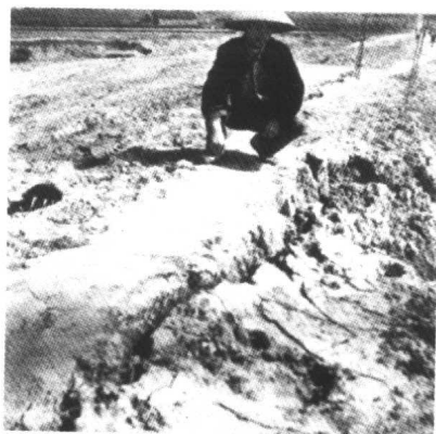
6. 溧阳上沛一汤桥公路边地裂缝
