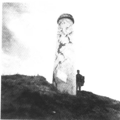
4. 溧阳陆埭东上窑厂烟囱震裂,出现 X 形裂缝
