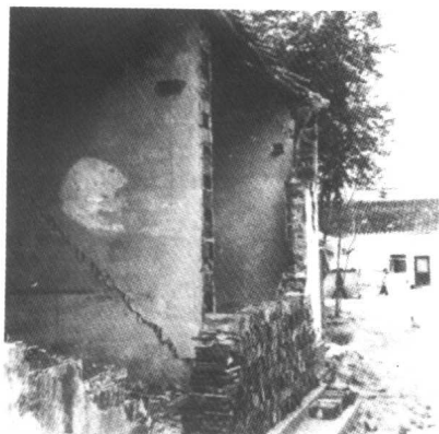
3. 溧阳上沛“八五”空斗墙瓦房,前墙倒塌,屋顶局部垮,隔震墙出现斜裂缝
