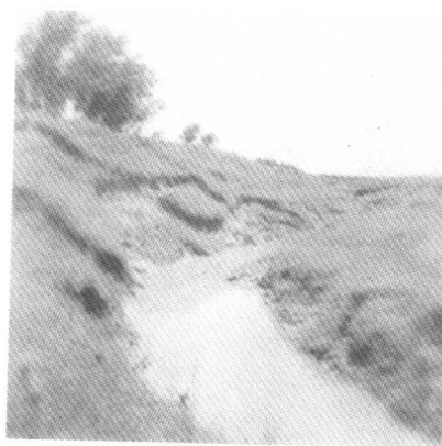
6. 溧阳上兴堰下村河堤滑坡
