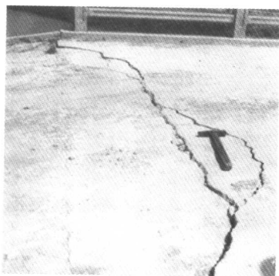
5. 溧阳上沛老虎山石桥桥面震裂
