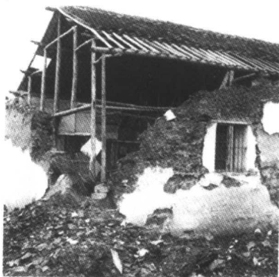
2. 溧阳上沛混有瓦砾,碎砖的夯土墙,严重倒塌
