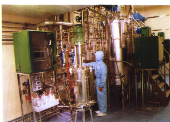
基因工程药物 GMP 中试车间
