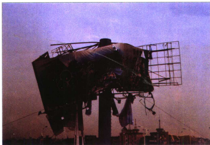
◆ 风灾后某广告牌桁架失稳
