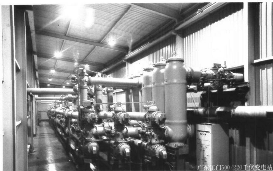
广东江门500/220千伏变电站
