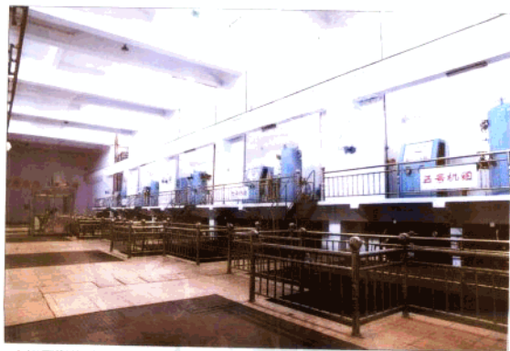
▲江厦潮汐试验电站主机房
