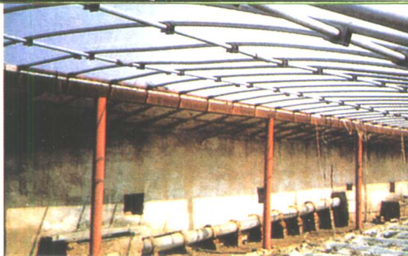
砖墙、钢柱、 管架组装式加温 温室火道呈坡状 ▶
