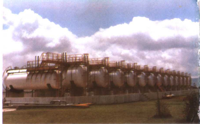
深圳蛇口深岩液化气储配站
