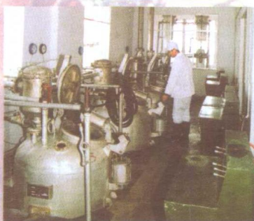
提取车间多功能提取罐
