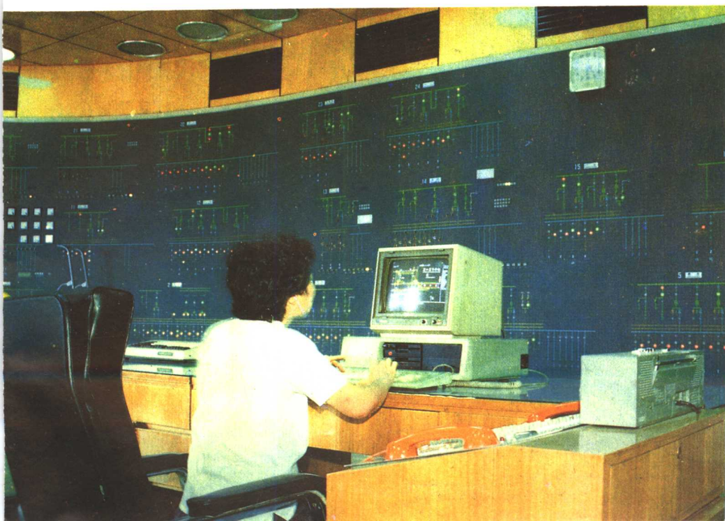
上海市公交总公司西区长途汽车站 负责全市无轨电车供电的上海公交总公司供电所调度室
