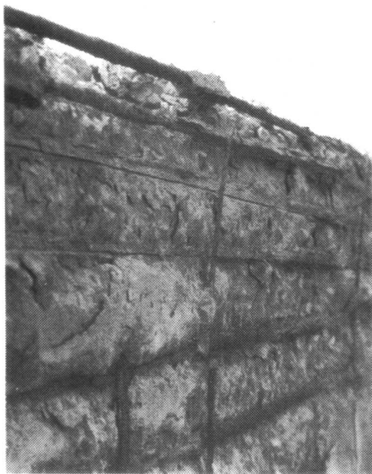
图 1-2 钢筋混凝土桥梁的保护层成片剥落
