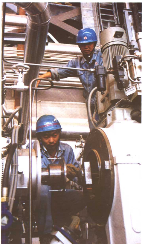
37. 2002年7月27日,国家重点工程阳城电厂 6 \times 35 万kW机组全部建成移交运营,图为工程技术人员在精心调试。
