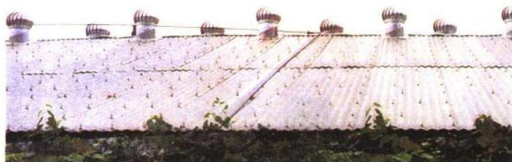
黄埔石化厂液化气站
