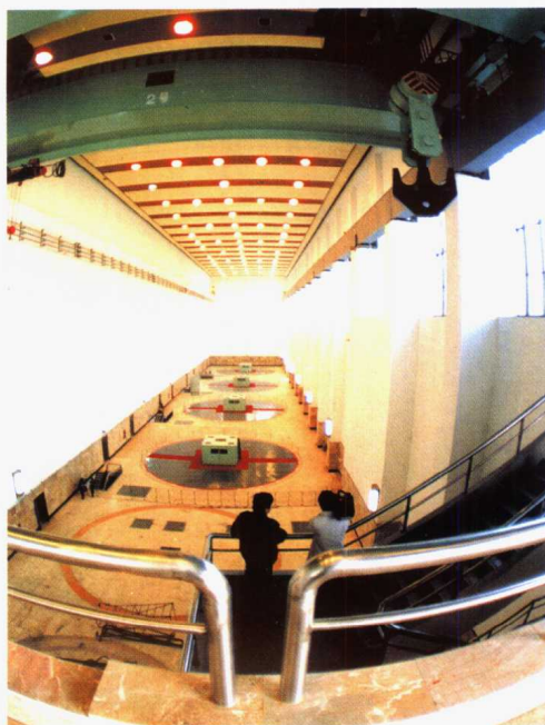
1995年10月全面投产后电站厂房内景
