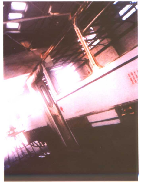
图 3.8.12 车门腐蚀及车顶、面板正在更换 (115 页)
