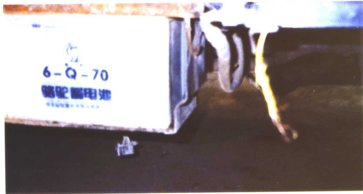
图 3.8.15 蓄电池箱、车底盘的腐蚀 (116 页)
