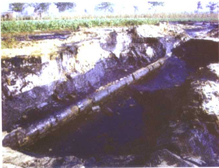
图 3. 1. 3 输油管线腐蚀泄漏情况 (49 页)
