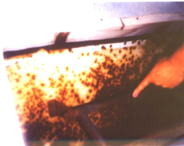
图 3.8.4 车顶框、车顶窗支架的腐蚀 (115 页)
