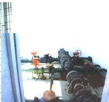
1958年建北戴河自来水公司泵房设备
