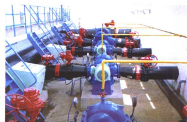
1999年6月拍摄进水泵房
