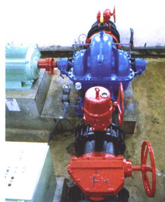
1999年6月拍摄进水泵房
