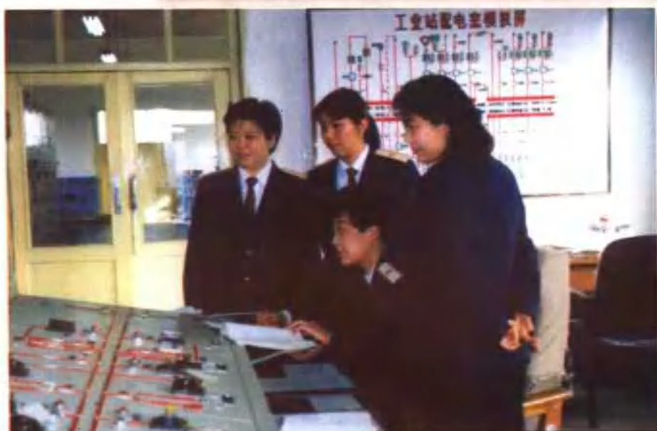
◀ 石家庄水电段配电值班员严密监视供电运行。
