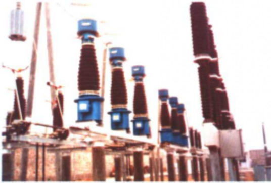
110kV浸油式电流互感器
