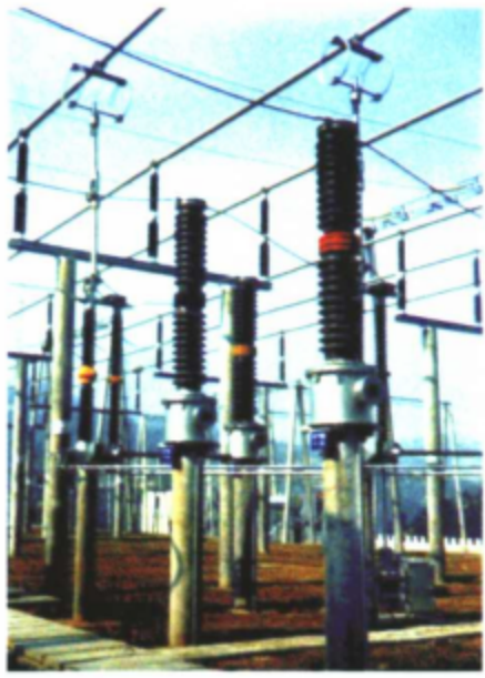
运行宜昌小雁溪 220kV电容式电压互感器
