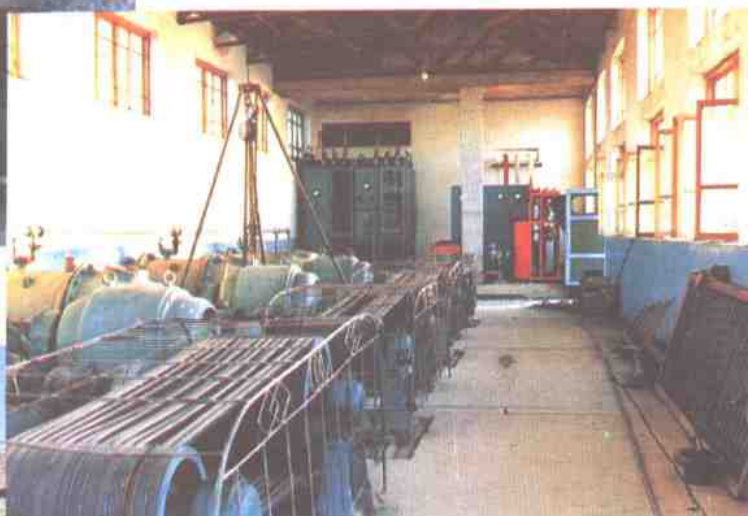
毕武庄扬水站
