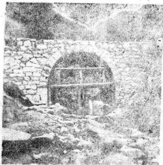
图9 拱跨5米半圆拱桥拱顶沉落变形
