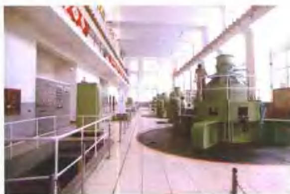
水电站发电机房
