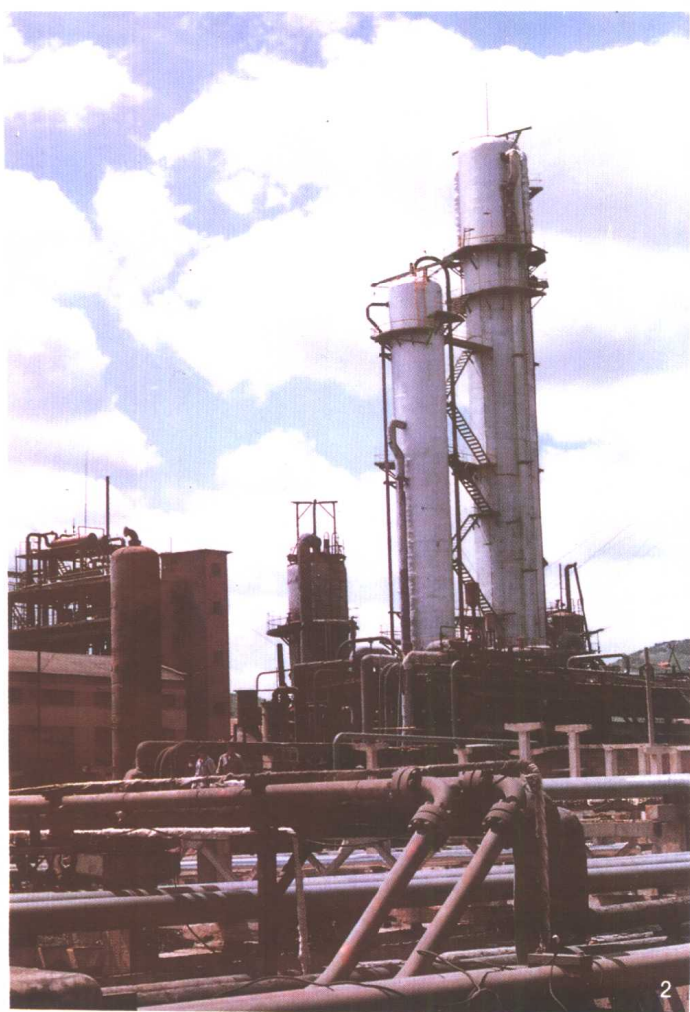
贵州化肥厂净化工段二氧化碳塔
