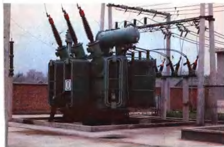
太和县110千伏变电所 20000千伏安主变设施
