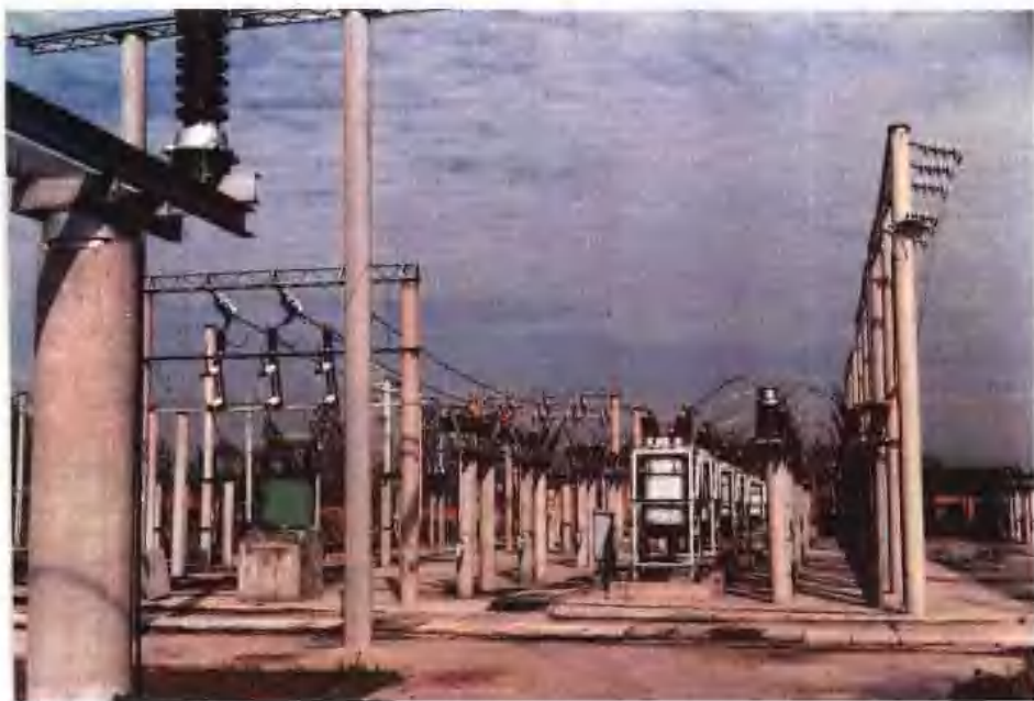
太和县110千伏变电所
