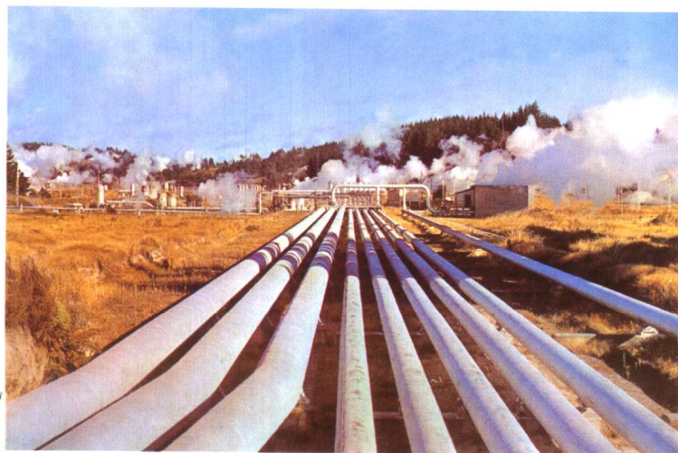
2.新西兰怀拉开地热电站
