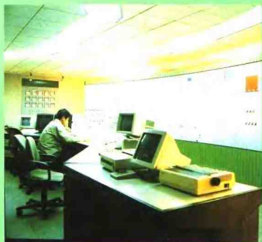
36. 地面中央集中控制室
