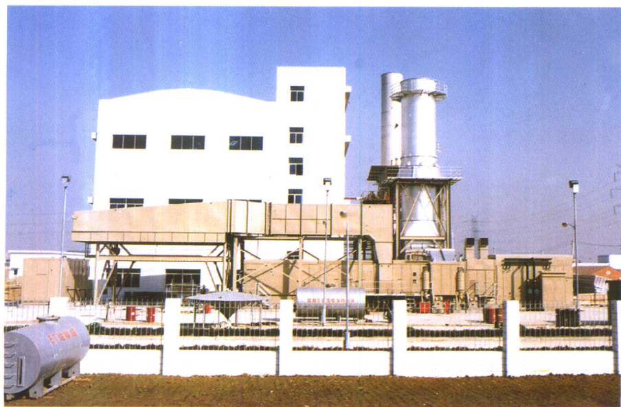
▲由南京汽轮电机厂生产安装在常州调峰电厂的 36MW 大型汽轮发电机组和一台 15MW 汽轮发电机组组成的一套 51MW 联合循环电站
