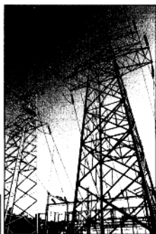
● 紅山變電站新架設的高壓電網
