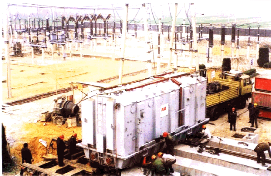
五里郢变电所
