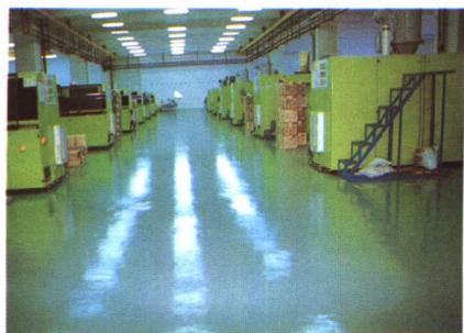
环氧自流平地板漆涂装地面
