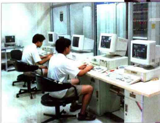
20000门程控电话机房
