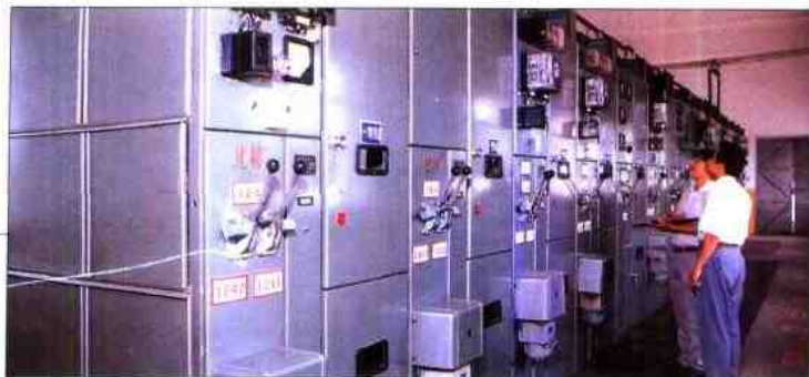
山区变电所控制室
