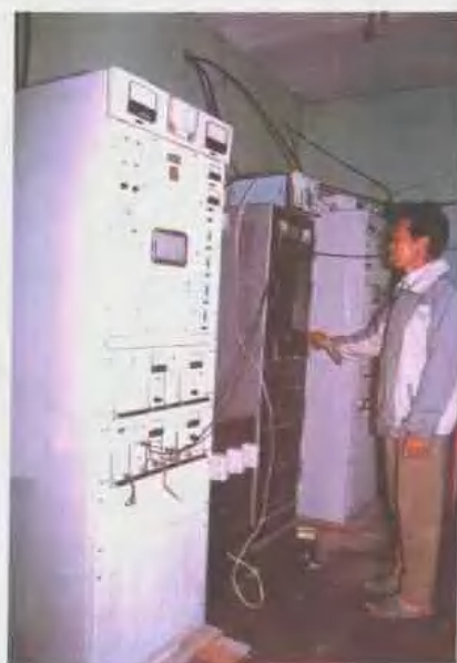
佛顶山电视差转台机房
