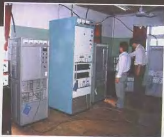
技术人员在机房测试 (1987)
