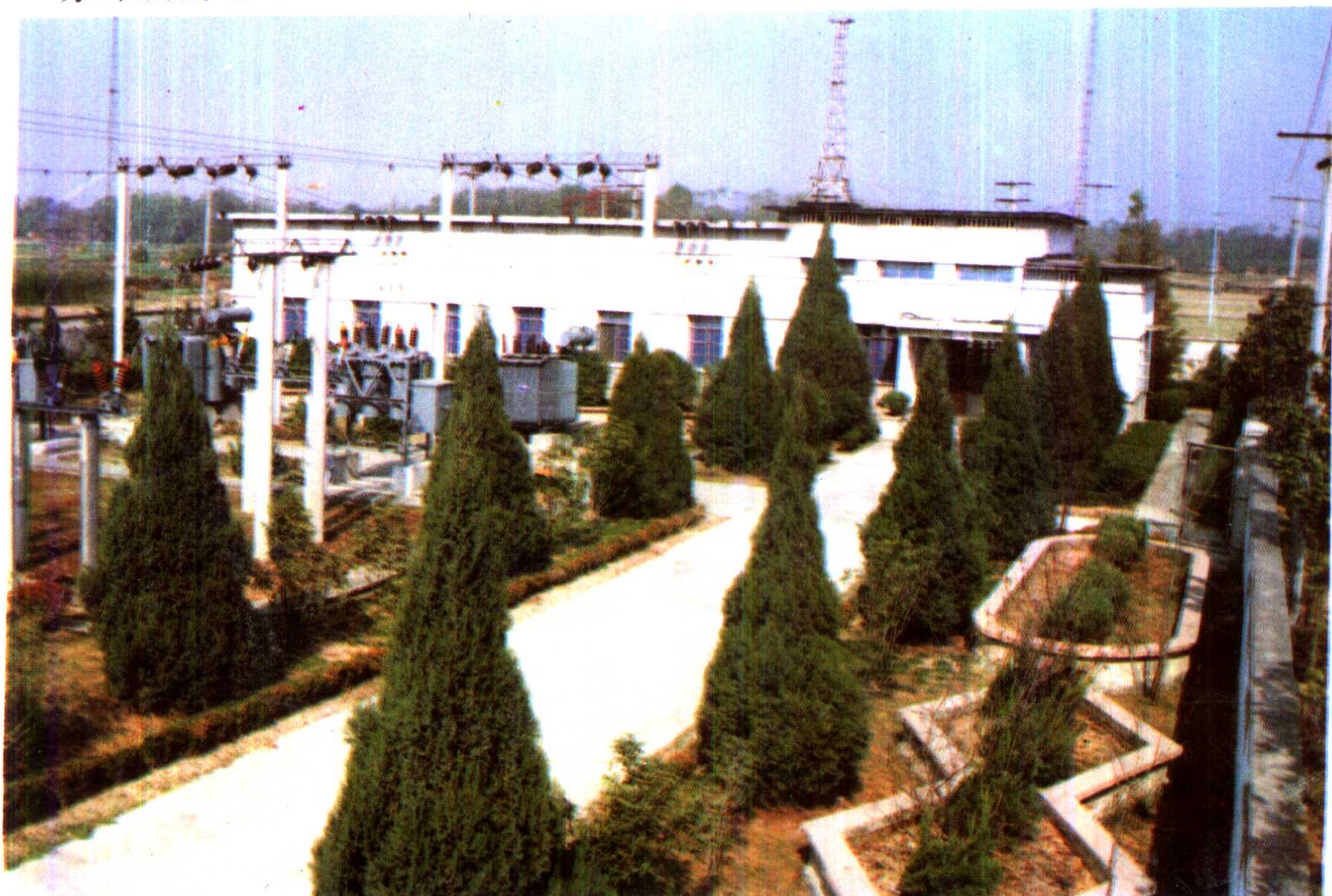
苏埠镇变电所
