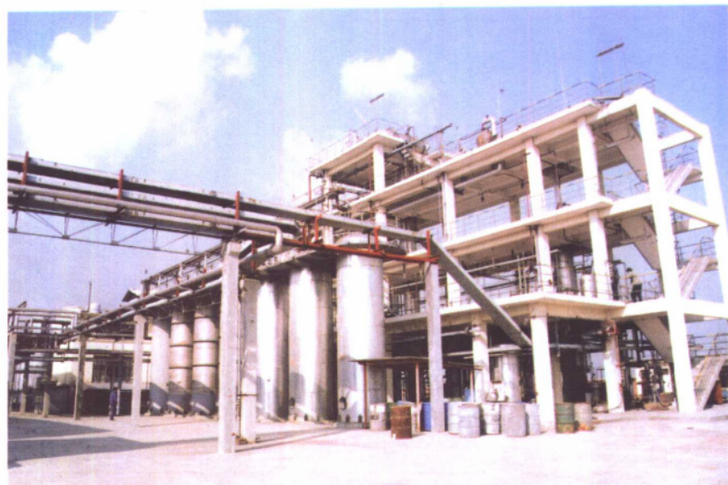
淮南化工总厂 DME 生产装置
