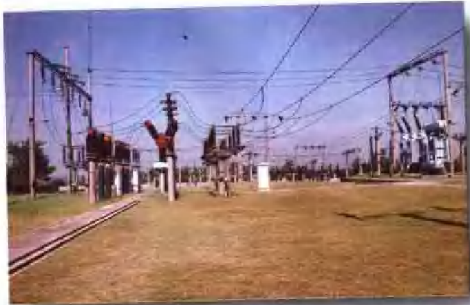
110 千伏变电所一角
