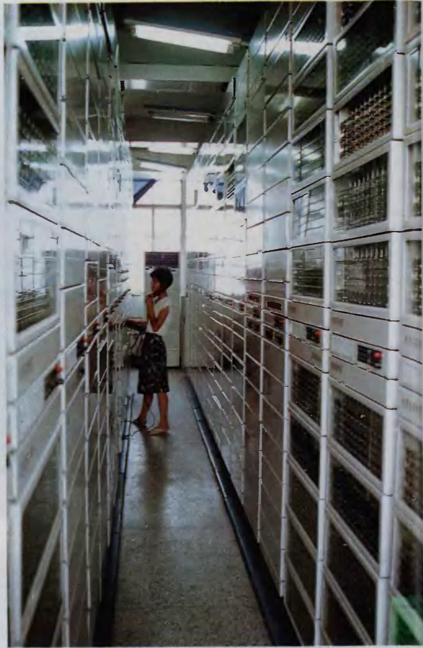
邮电局自动机房交换室
