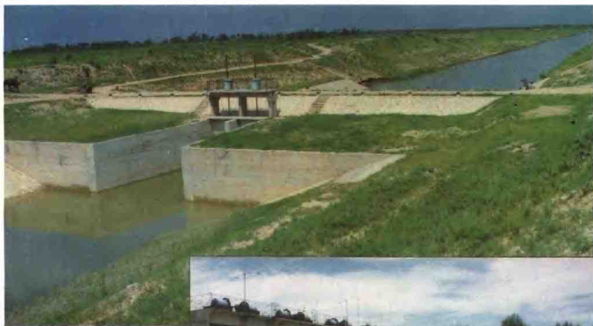
平原渠道节制闸
