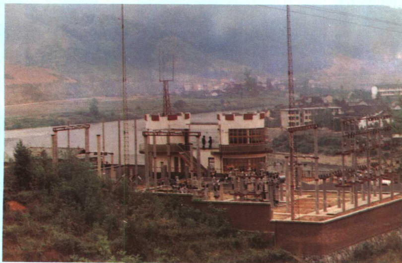
将乐县黄潭乡 3.5 万伏电脑程控变电所
