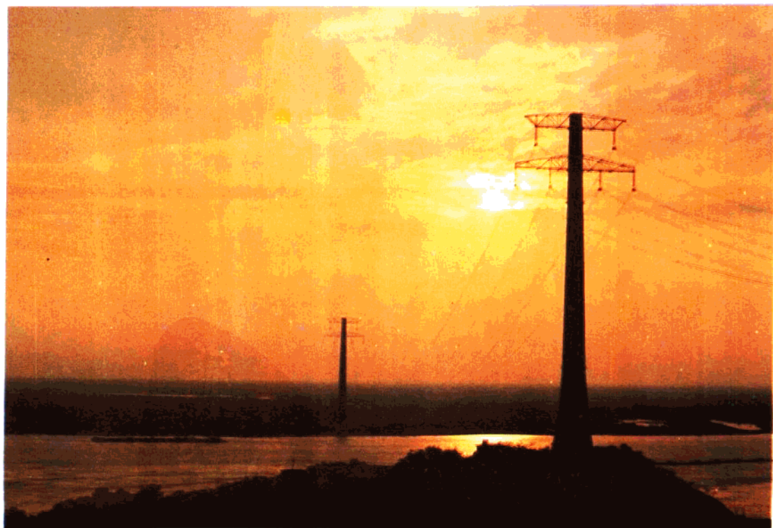
淮南—上海50万伏输变电线路过江电塔
