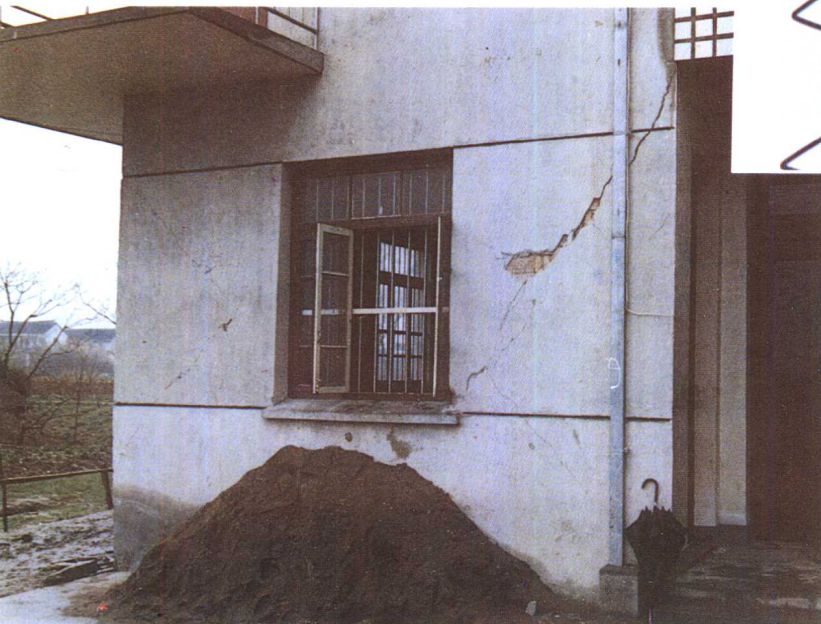
常熟何市乡俞桥村民居底楼墙体 出现裂缝。
