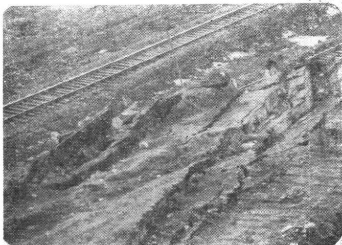
II-1 抚顺矿岩移危及铁路运输安全
