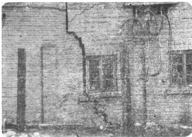
II-2 岩移使厂房开裂（抚顺矿）
