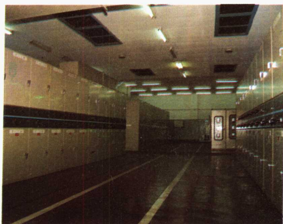
▲ 无锡市华晶电子集团公司 10 千伏变电所 6 千伏开关室
