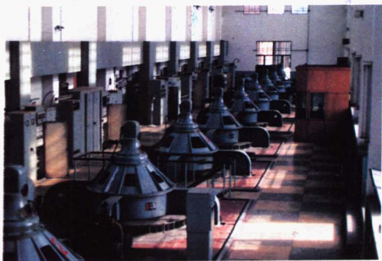
▲ 大型引江水利枢纽——江都提水站第四站
