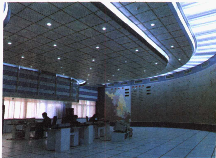
▲ 江苏省电网调度所调度室
