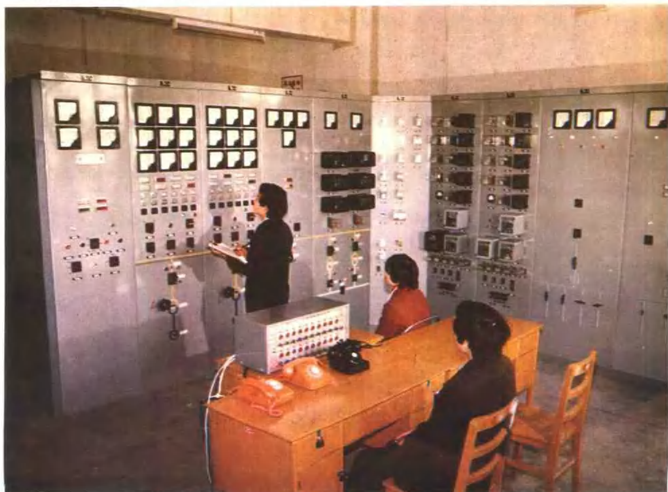
巴城电厂主控室 张 库供稿
