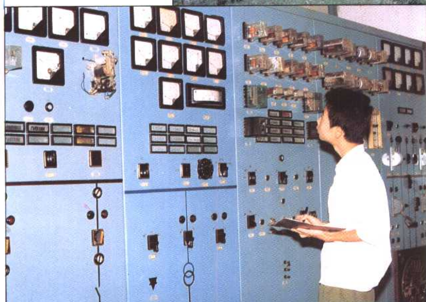
团结水库电站总控室
