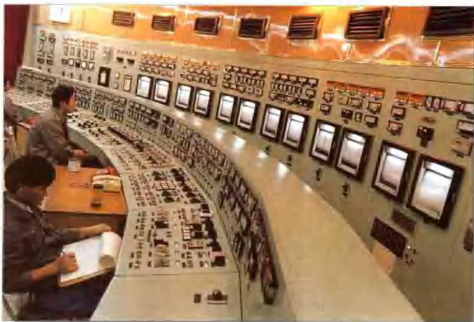
6号机炉控制室
