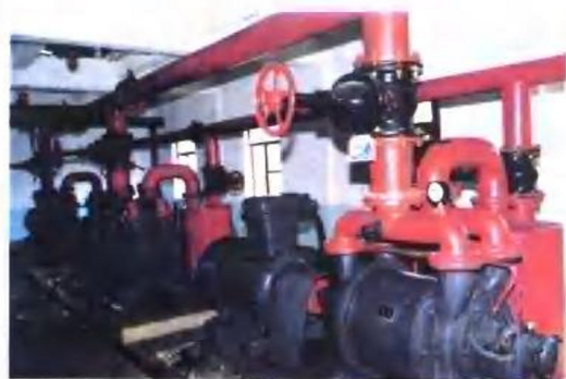
恩洪煤矿瓦斯抽放站
