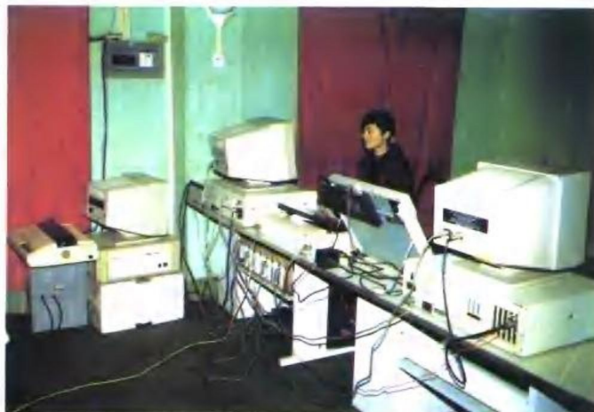
田坝煤矿瓦斯断电报警仪
