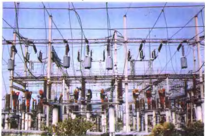
220KV 巢湖变电所
