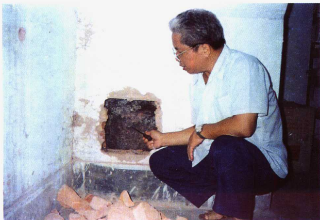
彩图 65 一楼楼梯底乳白蚁大型主巢，其分飞孔在二楼墙角顶上（见 64 彩图）
