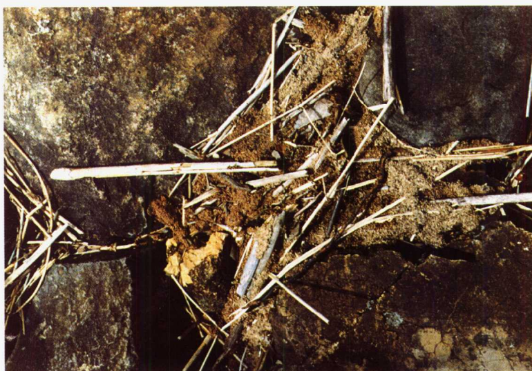
彩图 51 黑翅土白蚁在迎水坡护坡石缝隙中蛀食枯枝落叶
