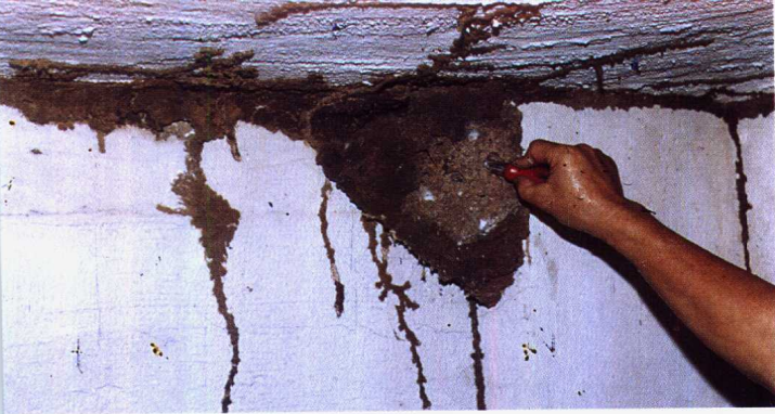
彩图7 现代化建筑, 钢筋水泥结构中的乳白蚁主巢, 白蚁从墙、梁交接裂缝处进入 (广西: 刘绍强提供)
