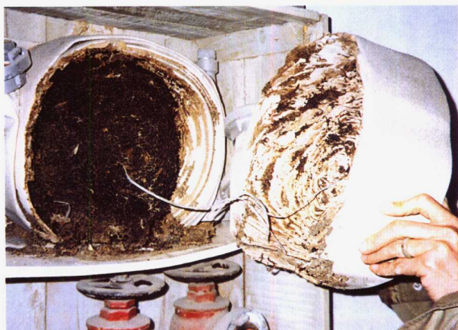
彩图 25 消防栓救火备用的水龙带被乳白蚁蛀烂筑成蚁巢（李学文提供）
