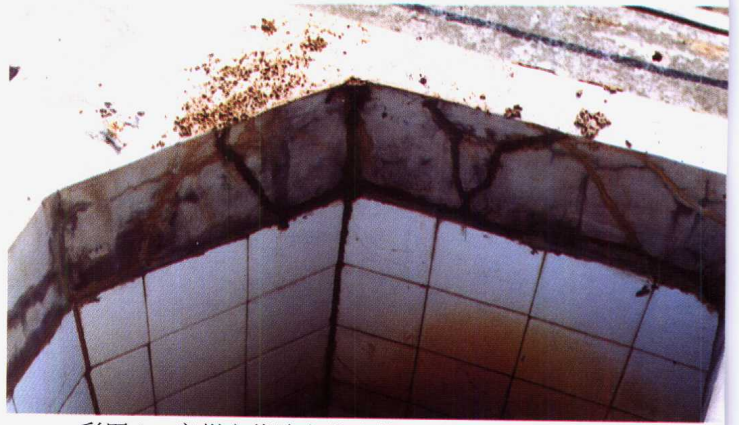
彩图1 广州文德路文化大楼21楼顶层蓄水池，台湾乳白蚁筑蚁路到池中取水（此乃真正的吸水线）
