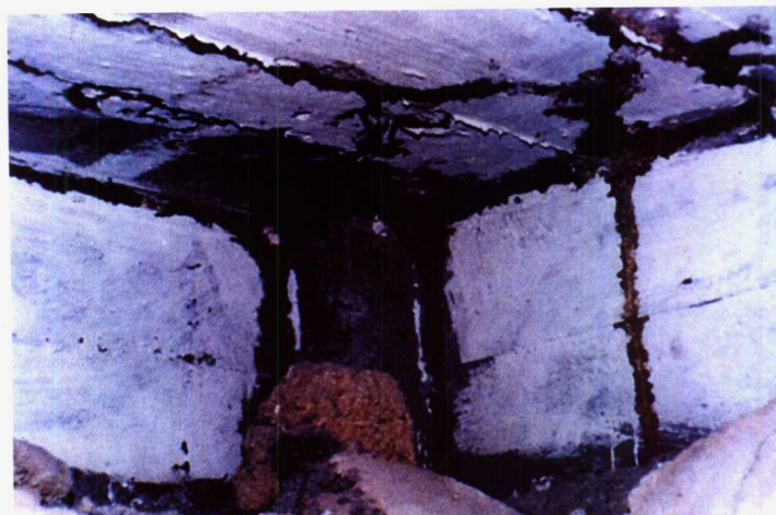
彩图8 乳白蚁危害建筑物, 在高层建筑首层地下室筑巢, 白蚁从墙壁与首层地板交接裂缝处进入 (广东科建公司提供)
